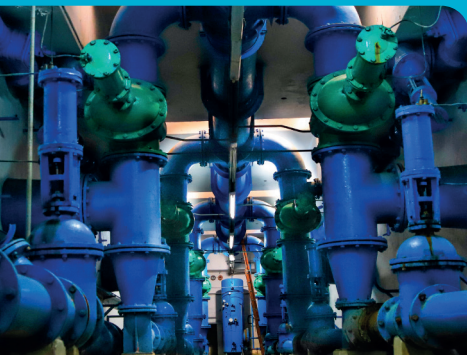
Conductos de Galería de Filtración
